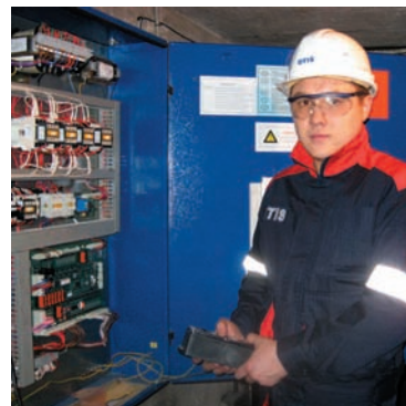
Регулярный технический осмотр оборудования
